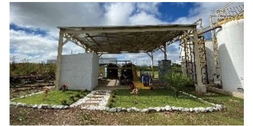
排水リサイクル設備(ブラジル工場)
